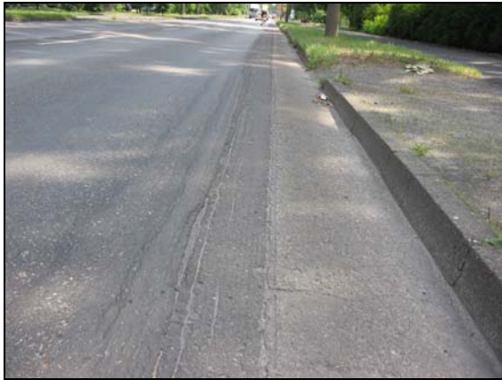
Abb. 30 Bitumenwülste am Fahrbahnrand Saarbrücker Straße
