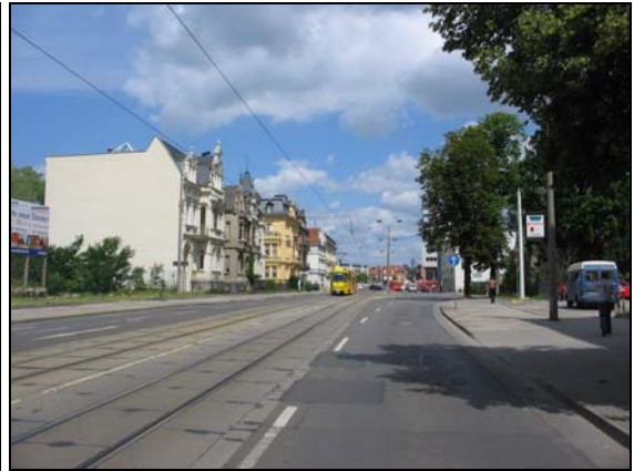
Abb. 31 Betonplatten im Gleisbereich Bahn- hofstraße
