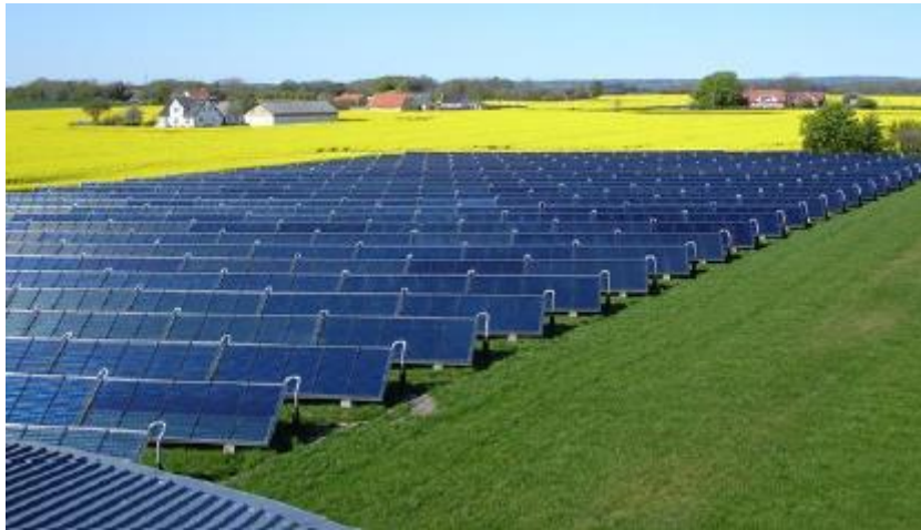
Abbildung 65 Solare Fernwärmanlage von Ulstedt 56
