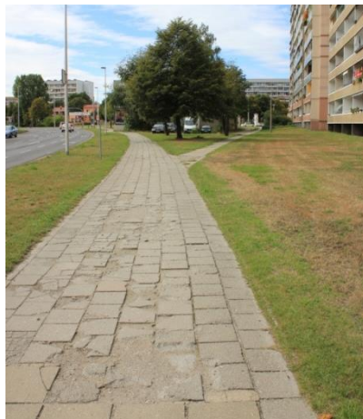
Abbildung 34 Geh-/ Radwegschäden Dissenchener Straße; Weggabelung Sandower Hauptstraße 17
