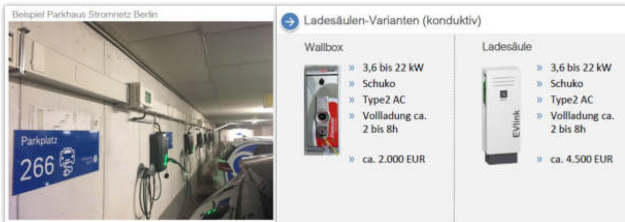
Abbildung 7-12 Parkhaus mit e-Ladeinfrastruktur und Stromschiene (Beispiel) | Ladesäulen-Varianten 23
