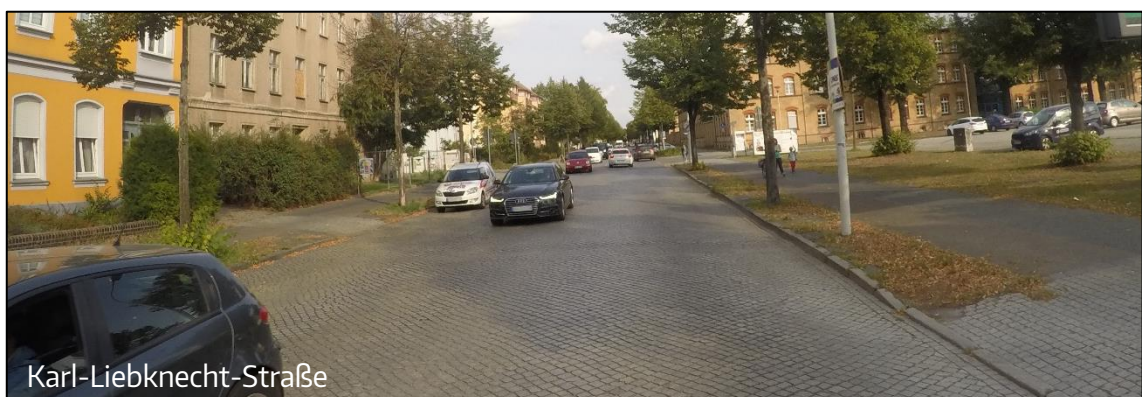
Abb. 3 Oberflächendefizite im Straßennetz mit Verkehrsaufkommen > 3 Mio. Kfz/a
