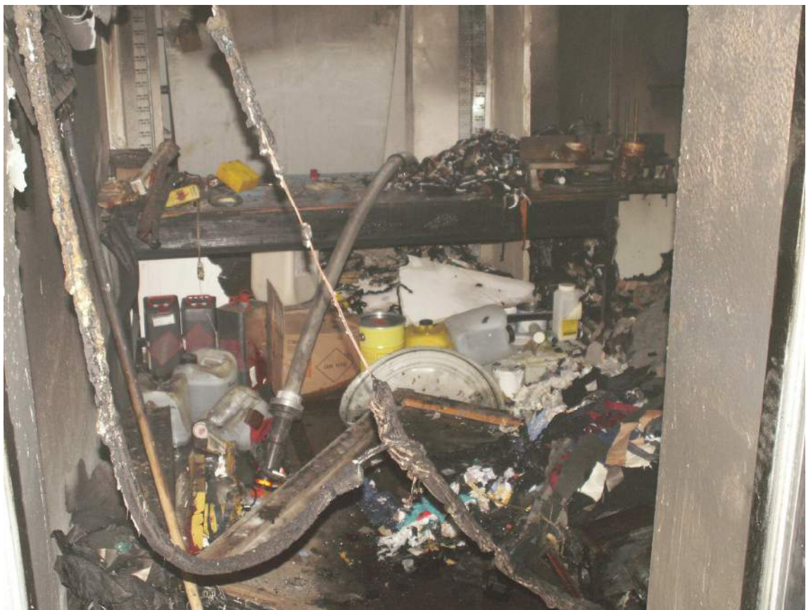
Brandausbruchsstelle – Lagerraum für Pyrotechnik
