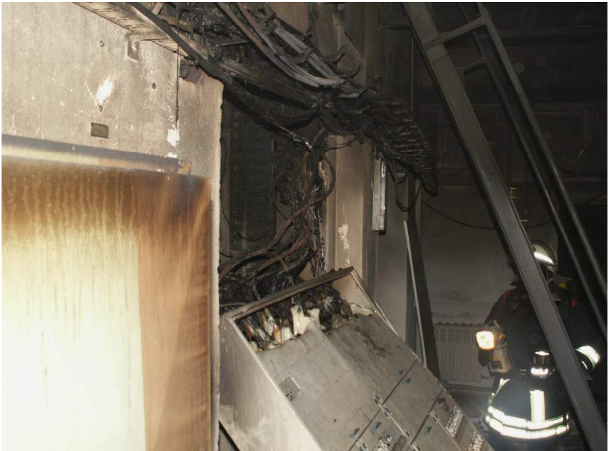
Bauliche Schäden infolge der Verpuffung
