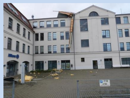
Quelle: BF CB/ Sturmschaden Dach
