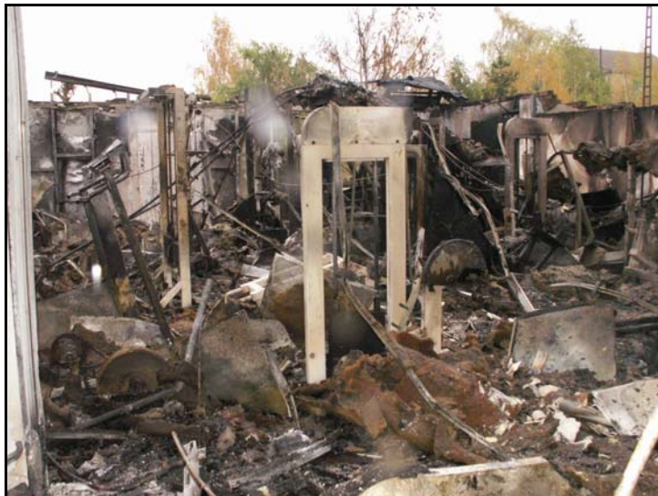
Totalschaden am Brandobjekt
