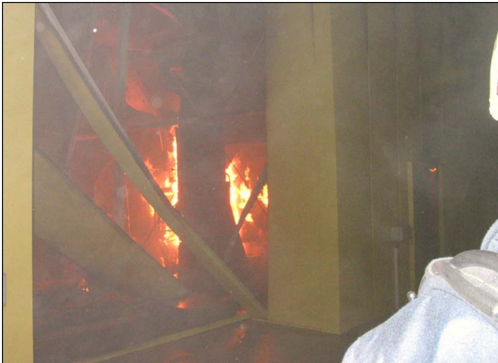
Brennendes Öl im Bereich der Turbine
