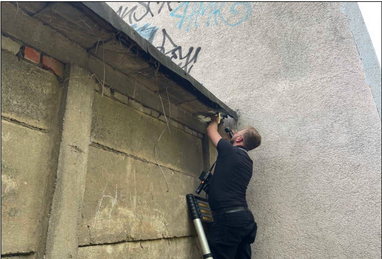
Abb. 14: Schuppen (5b) wurde ausgeleuchtet. Vertrocknete Reste vom Bewuchs der Vorjahre kann man an dieser Seite noch erkennen.
