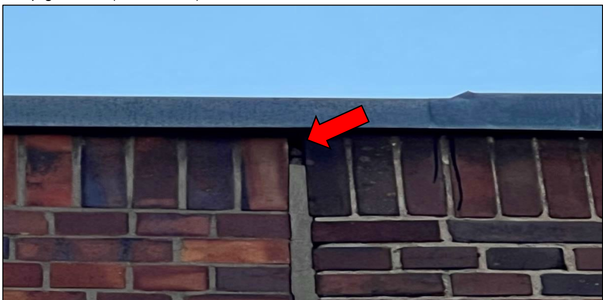
Abb. 18: Schadstelle am Dachrand vom Hauptgebäude (Abb. 2 Nr.1)
