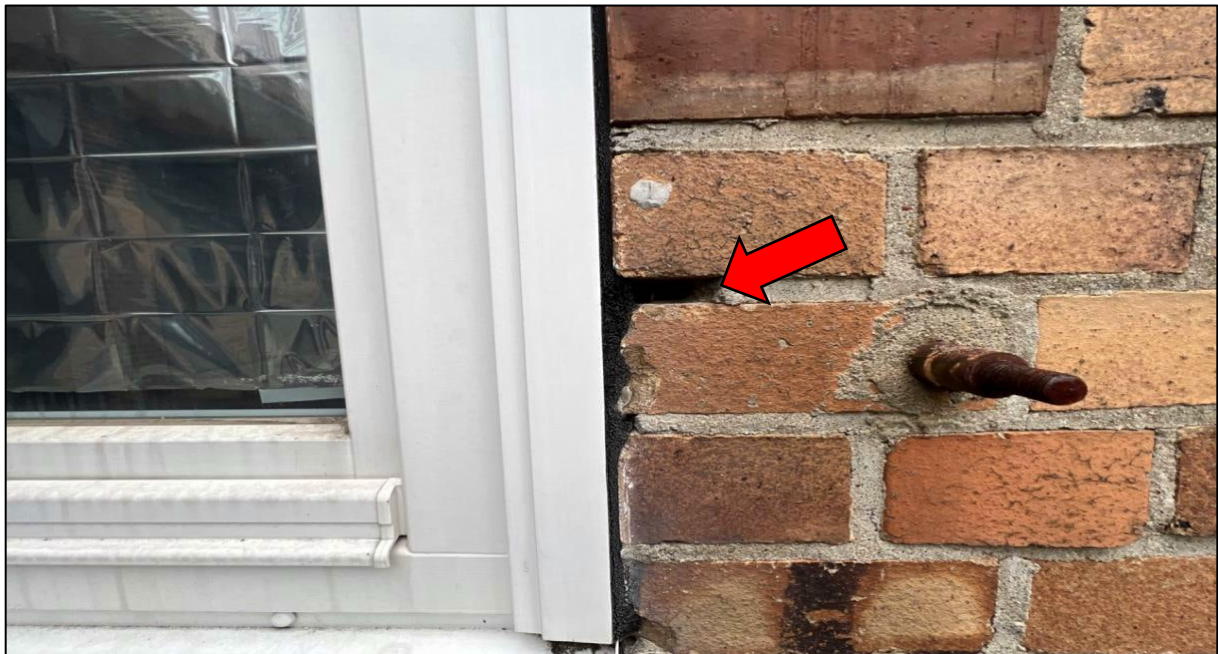
Abb. 17: Unbündig schließendes Dichtband (roter Pfeil), an einem Fenster am Hauptgebäude (Abb. 2 Nr.1)
