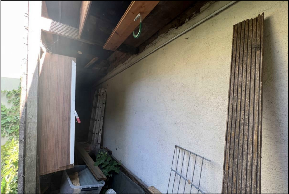
Abb. 24: Überdachung welche an die Rückwand des Schuppens (Abb. 2 Nr.2) angebaut wurde. Bei einem Abriss sind auch die auf dem Nachbargrundstück befindlichen und mit betroffenen Strukturen zu betrachten. In diesem Fall werden bspw. die hochgelegenen Ablagen gern als Brutplatz von Hausrotschwänzen genutzt.
